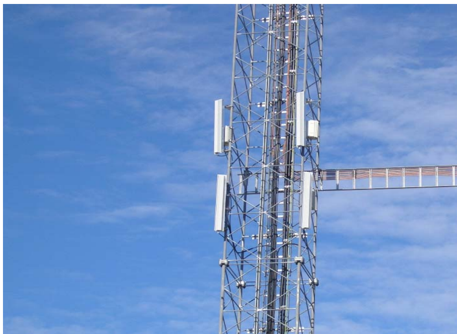
Figur 3.5 Sektorantenner montert i mast på Tørråsen i regionfelt Østlandet.
